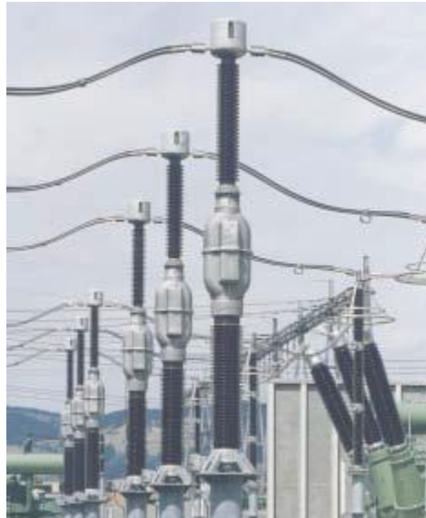
Slika 3. Fotografija naponskih transformatora VEOT 123 u polju
